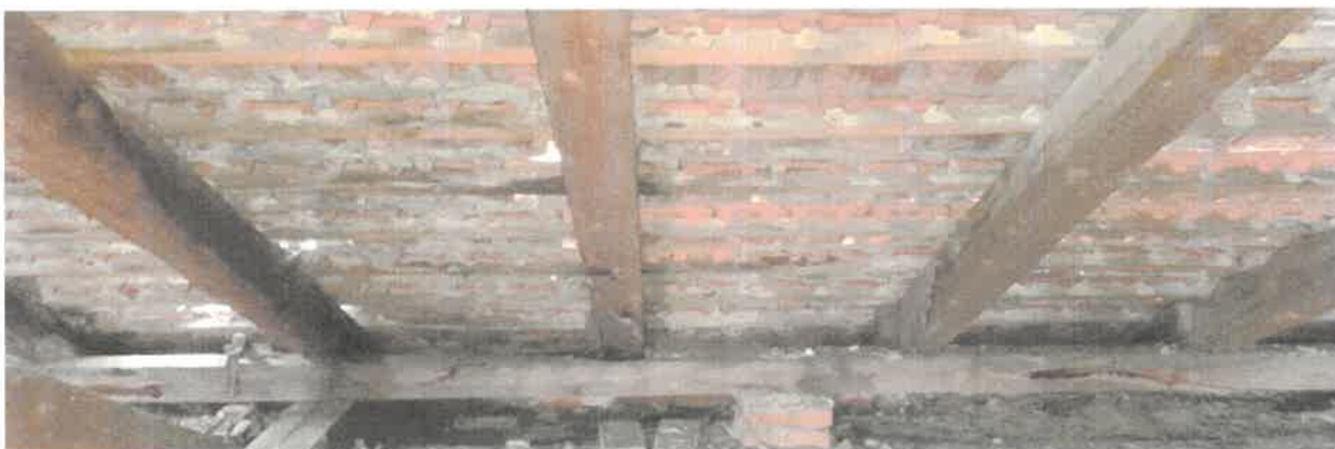
Prosvítající díry ve střešní krytině
