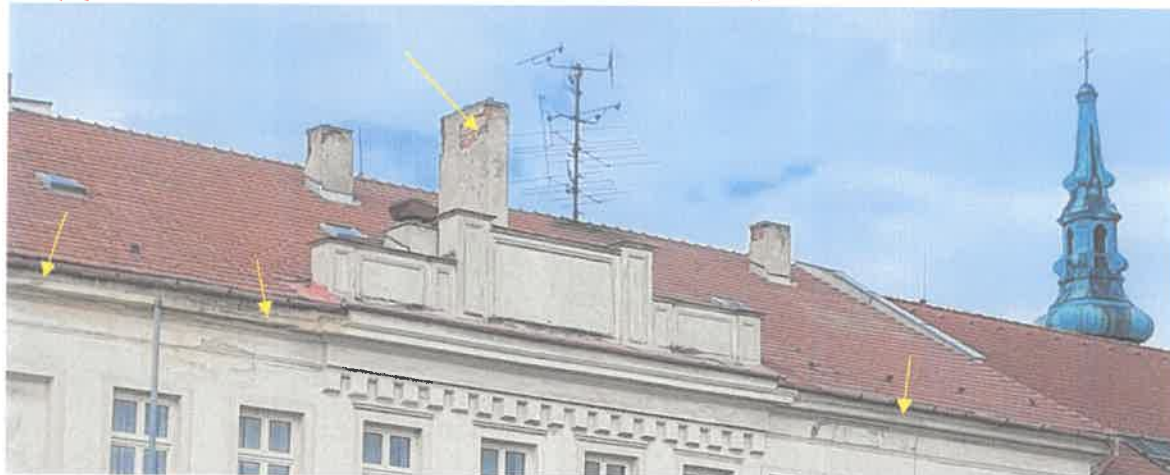
Nad ulicí gen. Hlaďo je porušená a mokrá římsa na více místech, odpadá i omítka z komínů
