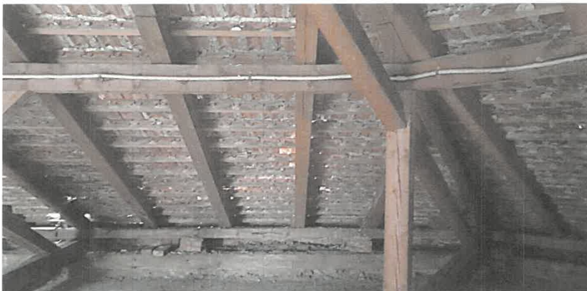
Množství poruch u nárožního zkosení s valbou
