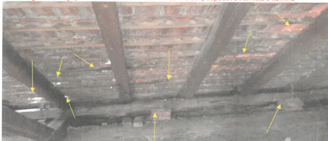
Místa zatékání krytinou a odlámané připevňovací malty, pilíčky pod okapovou vaznicí po 3 metrech
