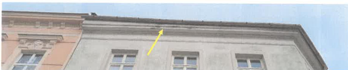
Odlupující se omítka a zatékání na římsě vedle zkoseného nároží – detail
