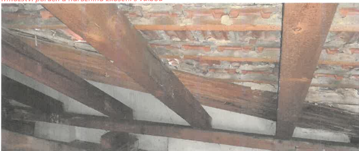
Poruchy u plechové průniku stříšky u tympanonu s taškovou krytinou
