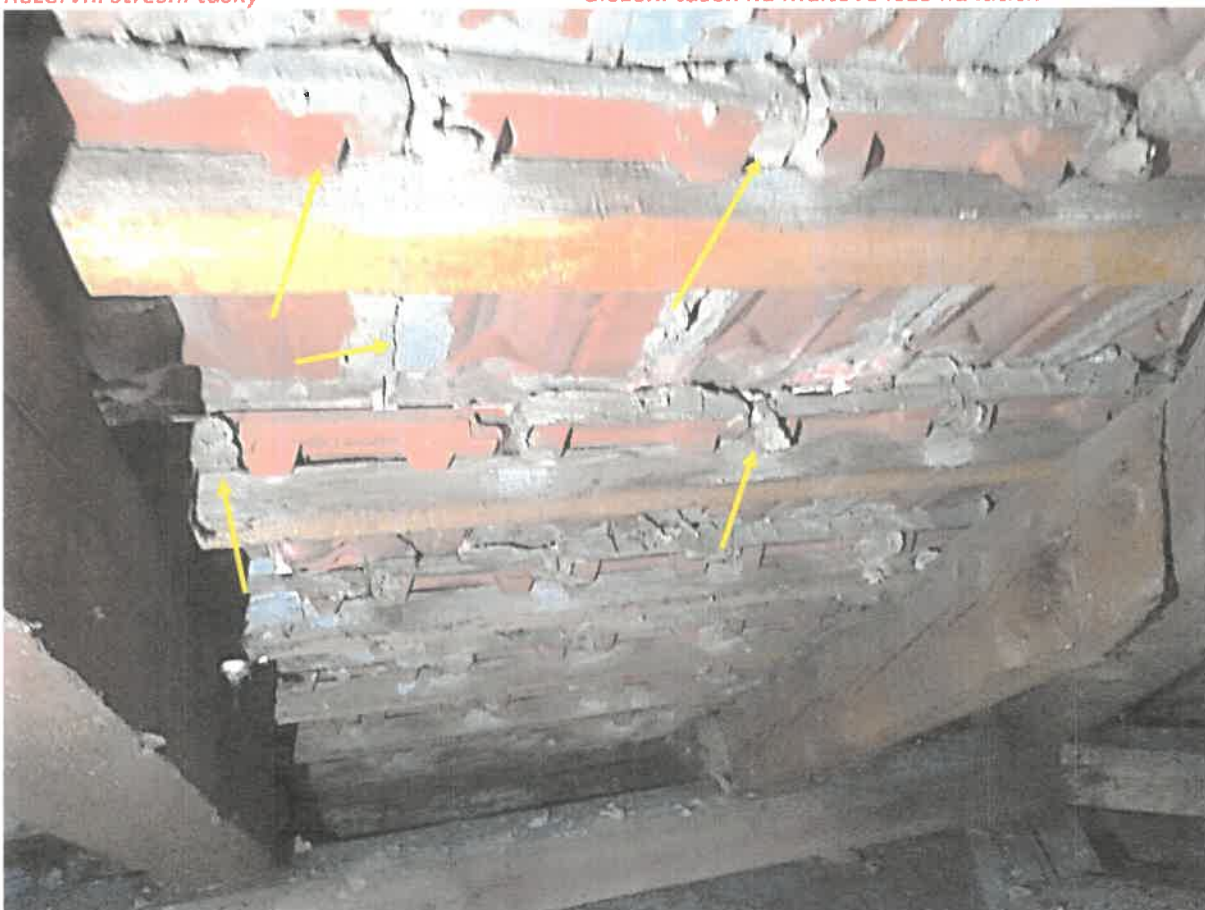
Odlámané maltové přichycení střešních tašek a praskliny mezi taškami
