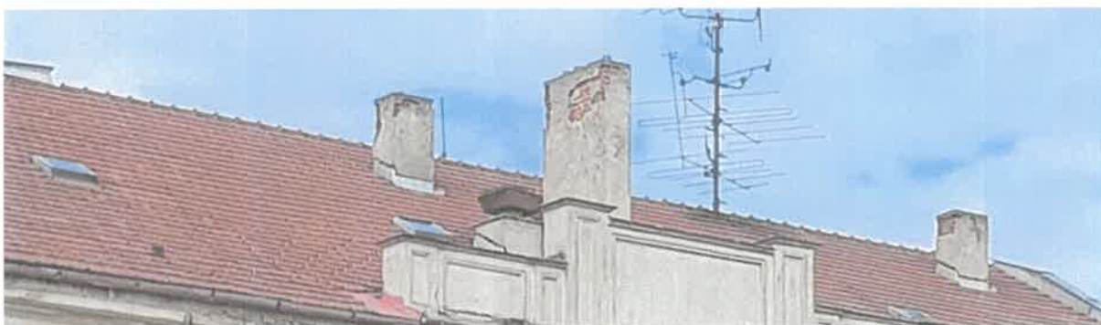
Omítka komínových hlav nad střechou odpadává
