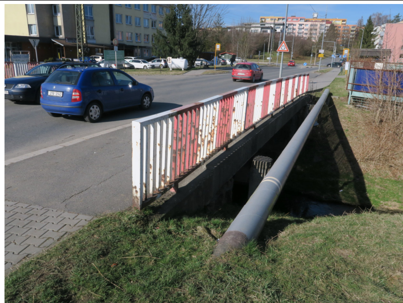
Vedení plynovodu vlevo.
