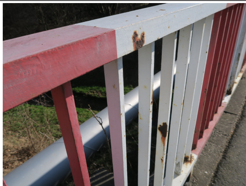
Typická koroze zábradlí na mostě.
