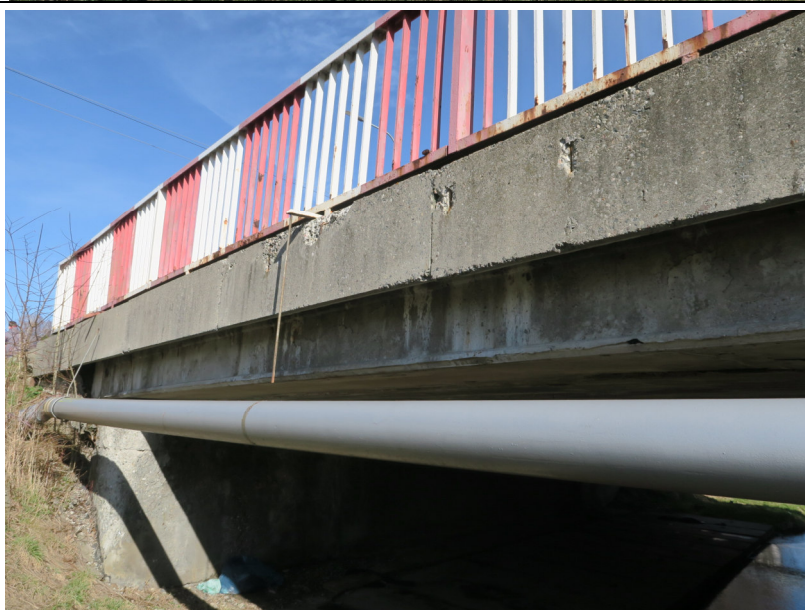
Poškozené/utržené závěsy plynovodu podél pravé římsy. Viditelné lokální poškození betonu říms.
