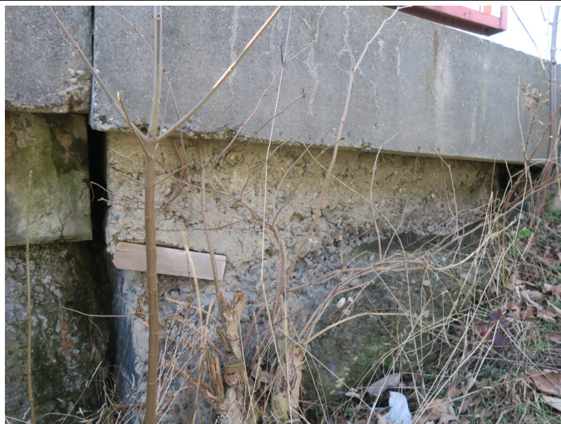
Destrukce betonu křídla OP1-L.
