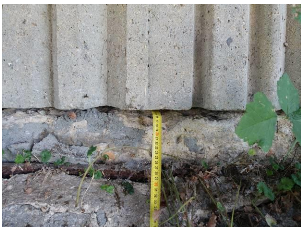
Hloubka spáry byla naměřena 160 mm
