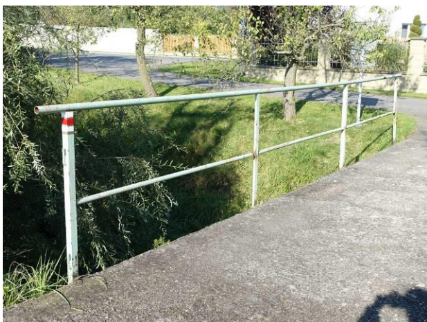
Zábradlí vpravo. Krátké a nenormové. Pohled proti směru orientace záznamu.
