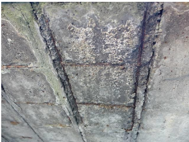
Degradace betonu stropních PZD desek. Koroze výztuže, rozpad hran.
