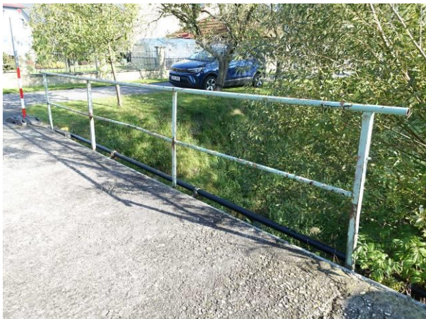
Zábradlí vlevo. Krátké a nenormové. Pohled proti směru orientace záznamu.
