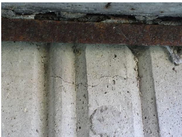
Opěra OP2. Průběžná trhлина pod uložením nosné konstrukce.
