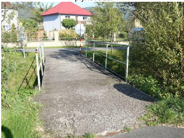
Pohled shora na mostovku. Degradovaný beton. Krátké zábradlí.
