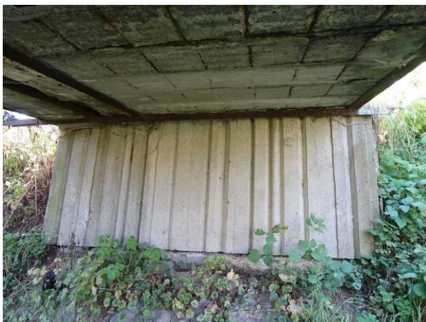
Opěra OP2. Odhalená malá horní část základu. Mezi základem a lícním prefabrikátem je spára.
