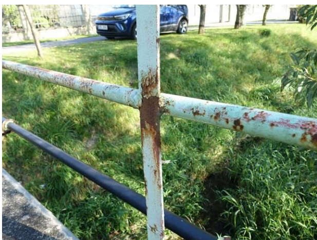
Detail koroze zábradlí
