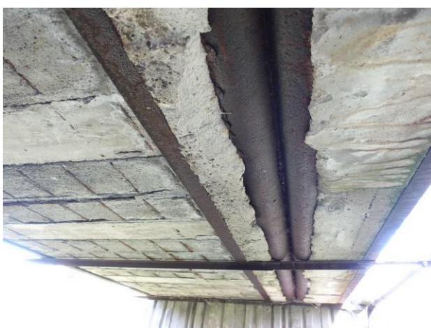
Levá strana nosné konstrukce. Plátková koroze ocelových trubek.
