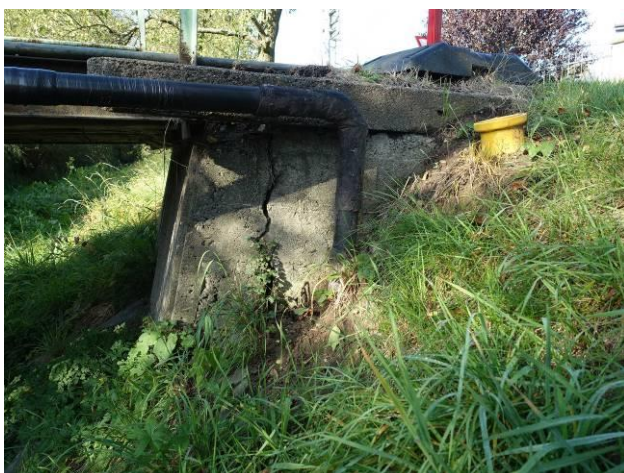
Opěra OP1, pohled zleva. Trhlina z boku za rubem opěry.
