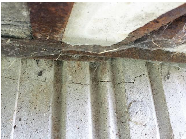
Opěra OP1. Průběžná trhlina pod uložením nosné konstrukce.
