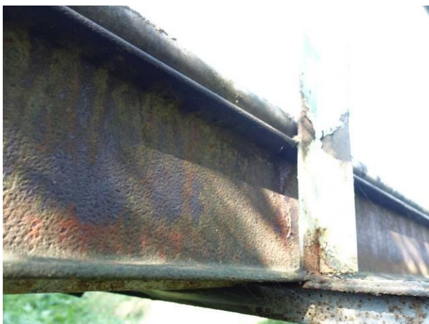
Koroze ocelových nosníků nosné konstrukce. Kotvení sloupků zábradlí a konzoly pro uložení plynovodu.
