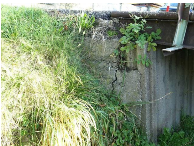
Opěra OP1, pohled zprava. Trhlina z boku za rubem opěry – detail.
