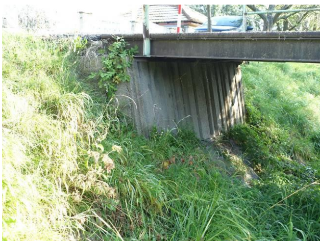
Opěra OP1, pohled zprava. Trhlina z boku za rubem opěry – zarostlá vegetací.
