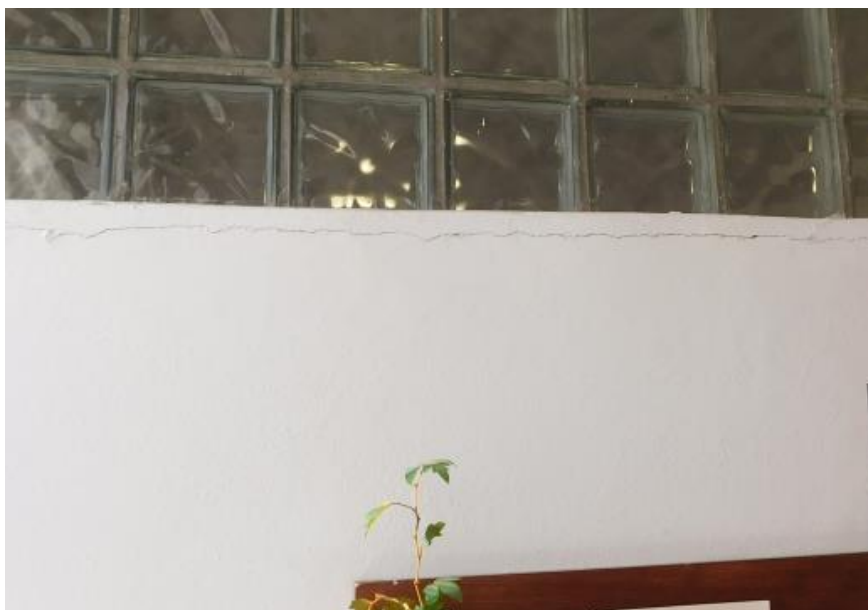
Obrázek 19: Vodorovná trhlina na rozhraní materiálů (zdivo příčky / skleněné Luxfery).
