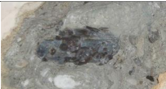
Obrázek 50: Výztuž v sondě D3-1, \phi V18 (spodní povrch stropu nad 3.NP).
