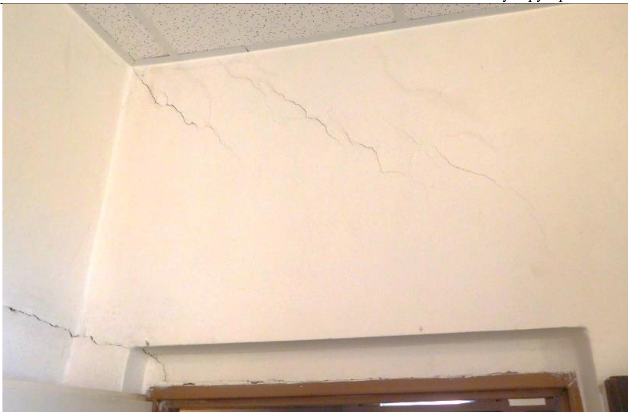
Obrázek 27: Trhliny v příčce (kancelář správce, 3.NP).
