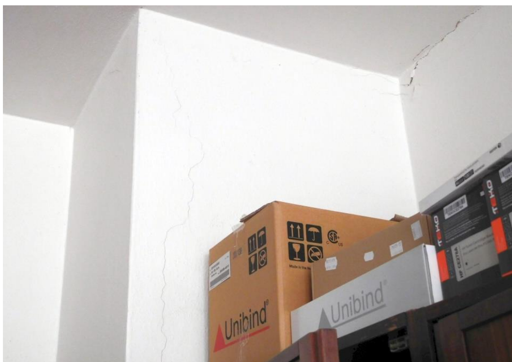
Obrázek 21: Trhliny v příčkách.
