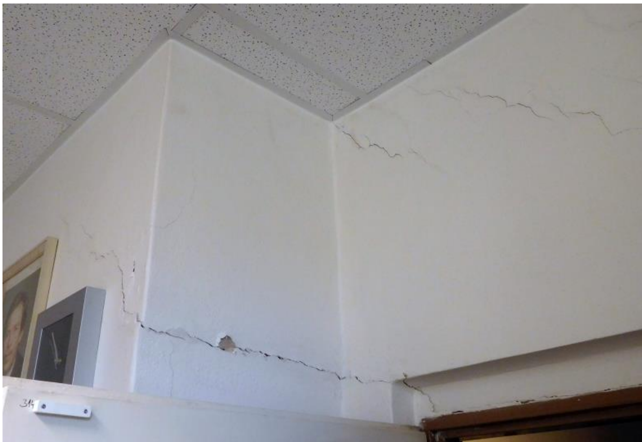
Obrázek 28: Trhliny příček (kancelář správce, 3.NP).
