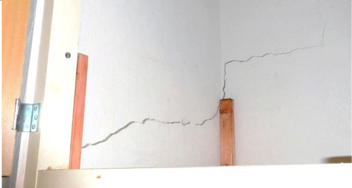
Obrázek 25: Trhliny v příčkové nice pro vestavěnou skříň.
