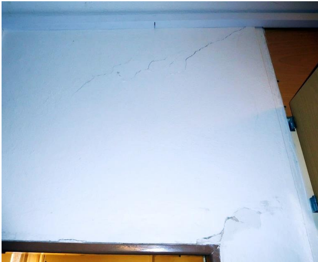
Obrázek 26: Trhliny v příčce.
