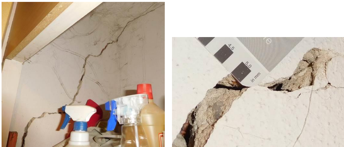
Obr. 17 – Trhliny v příčkách výklenků pro vestavěné skříně v chodbách.
