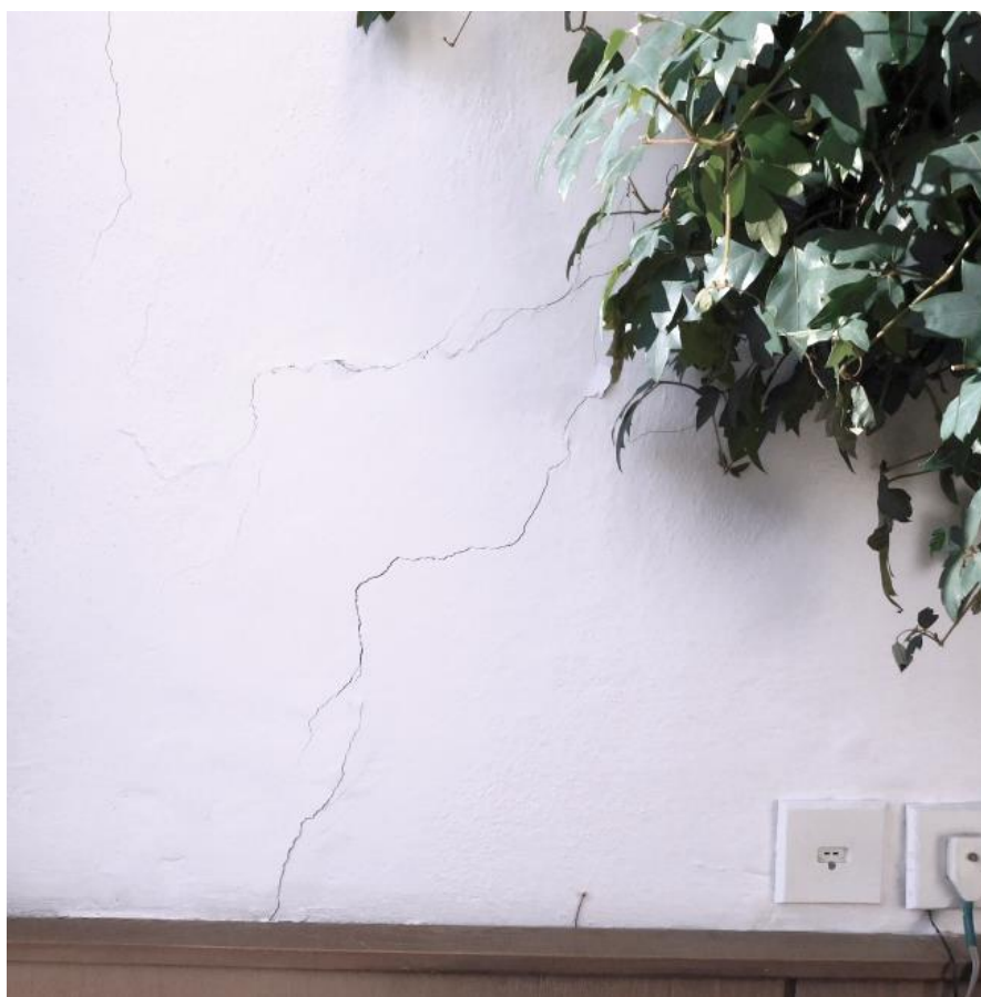
Obrázek 23: Šikmé trhliny příčkou (vlevo je obvodová nosná stěna).
