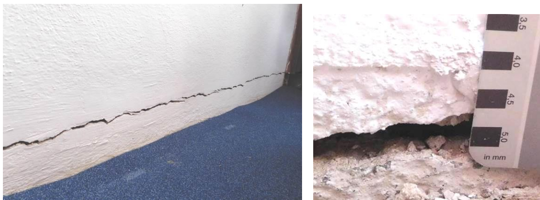
Obr. 7 – Horizontální odtržení příčky nad podlahou, detail šířky trhliny.
