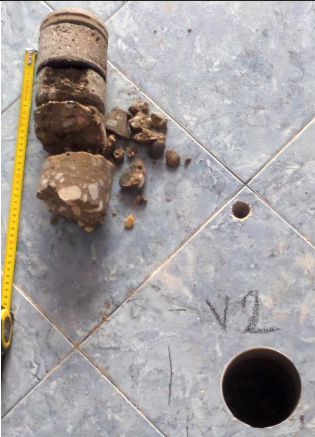
Obrázek 59: Vývrt V2 (strop nad 2.NP, koupelna). Nosná stropní deska (pod vrstvou podlahy) není celistvá, horizontální spáry, kaverny, rozpad vzorku.
