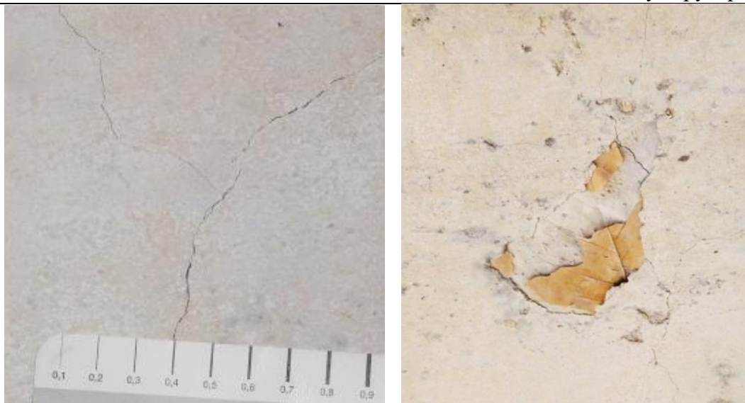
Obrázek 34: Trhlinky a nečistoty na spodním líci stropní železobetonové desky, 3.NP.
