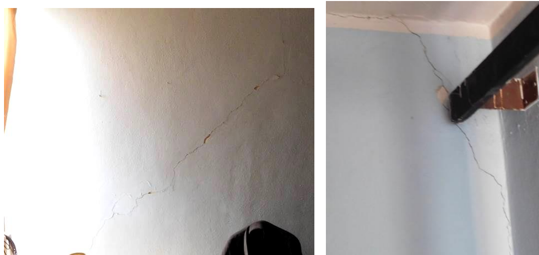
Obr. 15 – Další ukázka šikmých trhlin příčkami.
