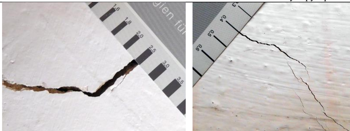
Obrázek 22: Měření šířek trhlin v příčkách.
