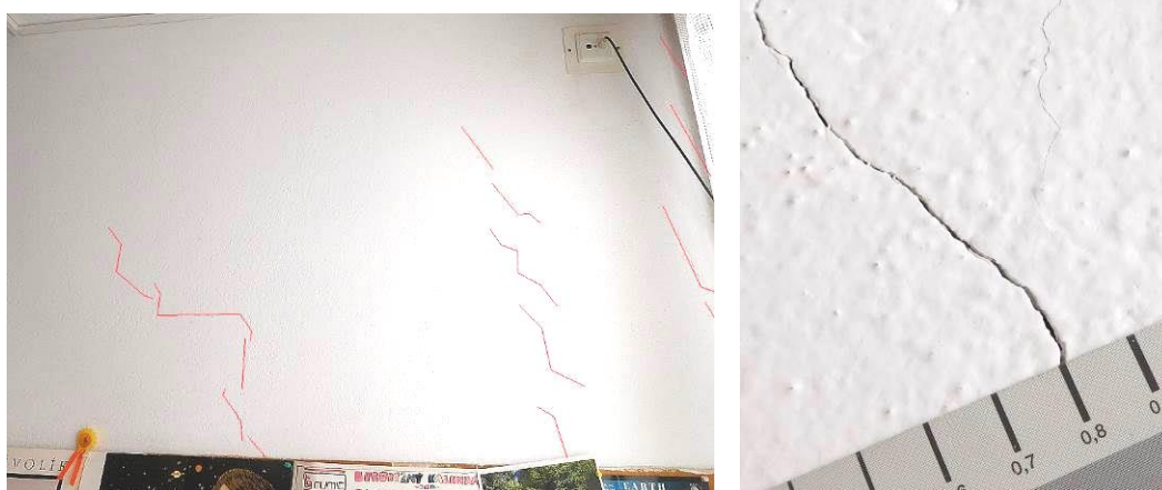
Obr. 8 – Trhliny příčkou poblíž obvodové stěny.
