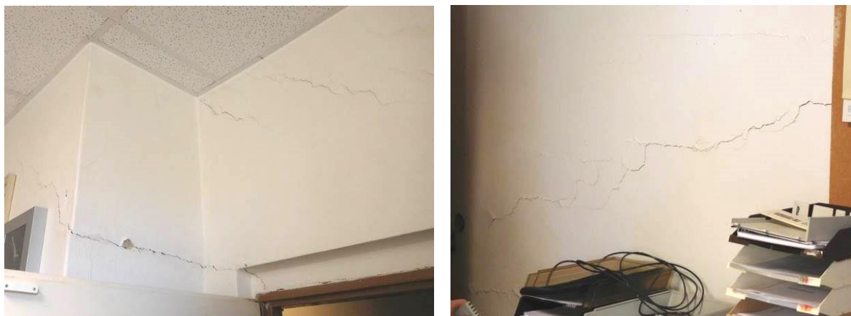
Obr. 13 – Trhliny v příčkách kanceláře správce divadla (3.NP).
