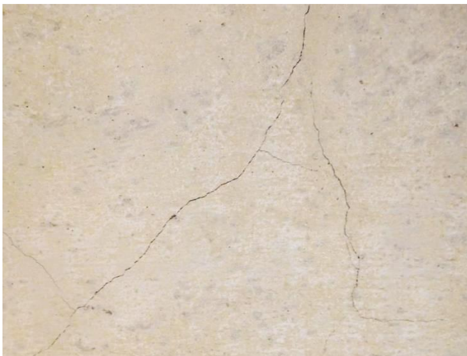
Obrázek 35: Trhlinky na spodním líci stropní konstrukce, 3.NP.
