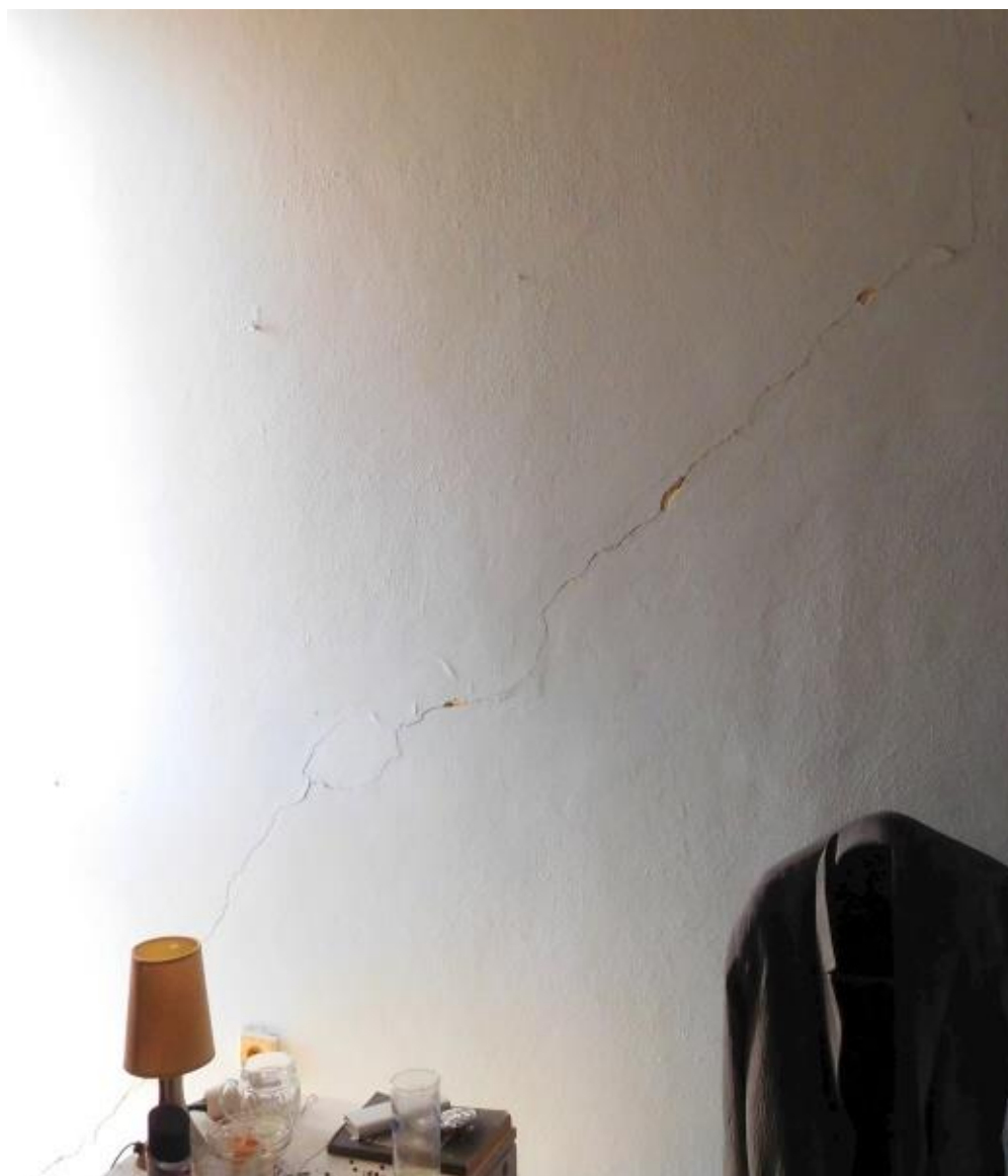
Obrázek 42: Šikmá trhlina příčkou, vlevo je obvodová nosná stěna.
