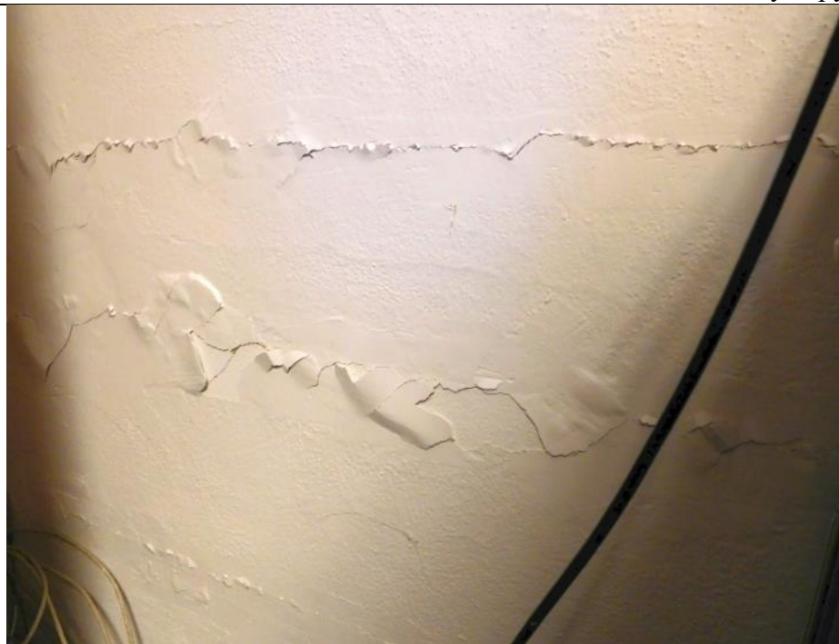
Obrázek 31: Trhliny příčkou, patrný porušené vrstvy oprav a přemaleb.
