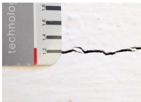
Obrázek 24: Měření šířky trhliny.
