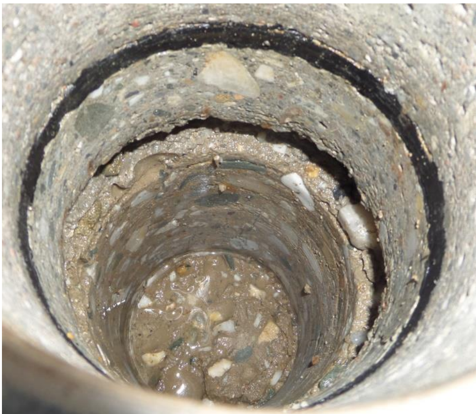
Obrázek 61: Vývrt V2 (strop nad 2.NP, koupelna). Kaverny a horizontální spáry v nosném betonu stropní desky.
