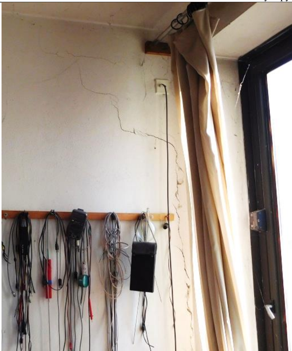
Obrázek 39: Trhliny v příčce, vpravo obvodová nosná stěna (služební místnost, 4.NP).
