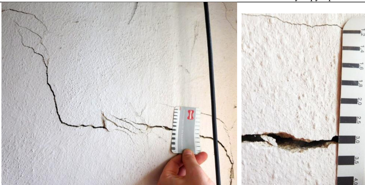
Obrázek 41: Trhliny v příčce.
