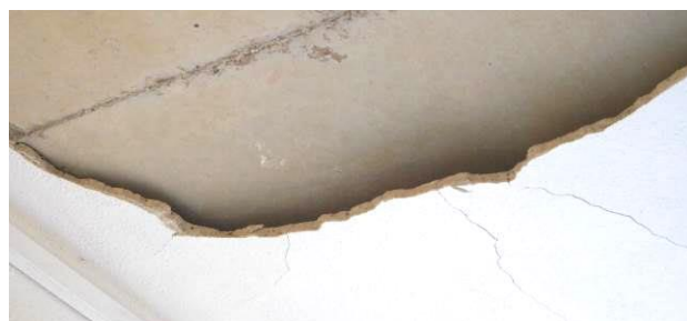
Obr. 18 – Nesoudržná, opadající omítka (koupelna ve 3.NP).
