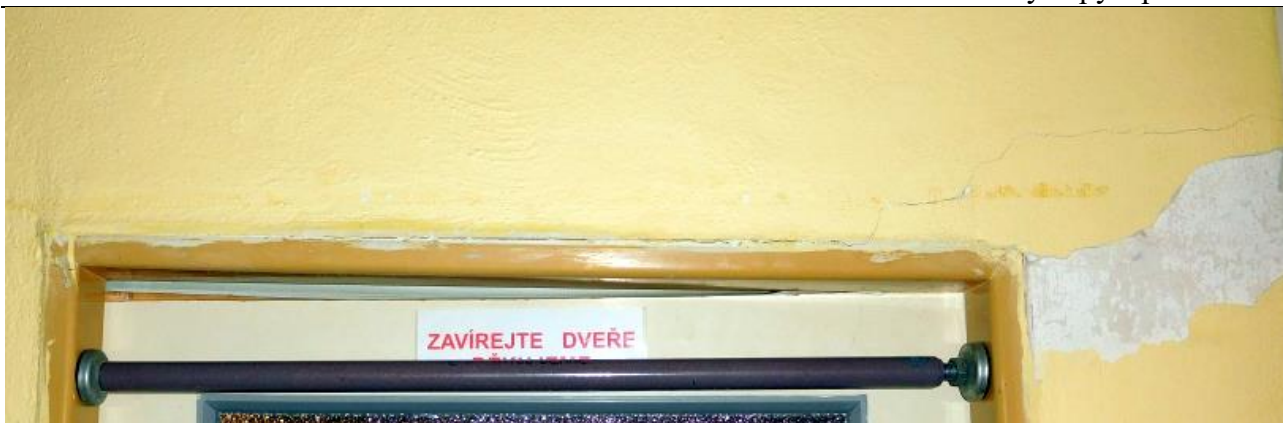
Obrázek 47: Zkosený dveřní otvor (zárubeň / křídlo) a trhlina příčkou.
