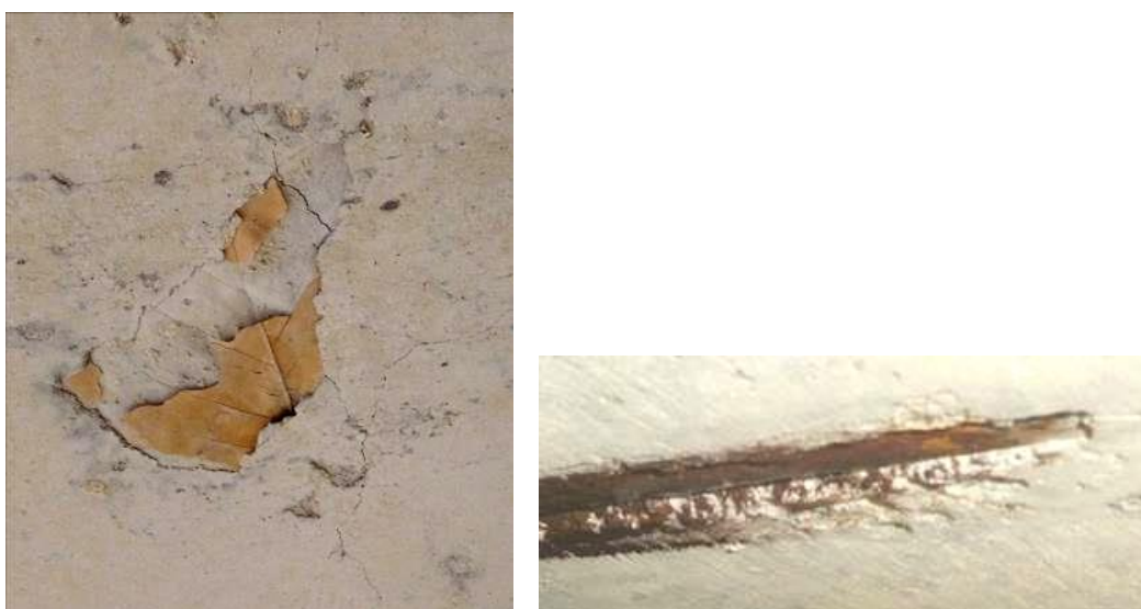
Obr. 21 – Nečistota v bedně (list), odhalený povrch výztuže – nulová krycí vrstva (kancelář správce, 3.NP).
