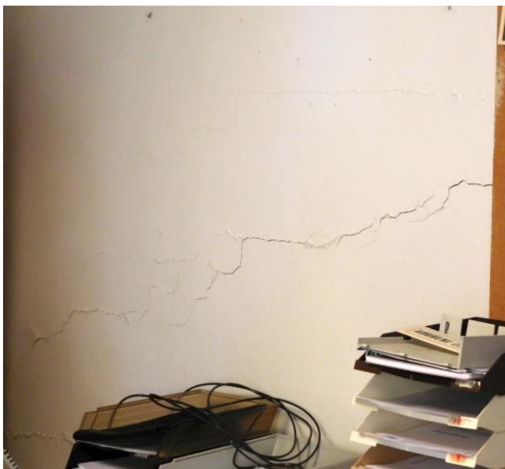
Obrázek 30: Trhliny příčkou (kancelář správce, 3.NP).
