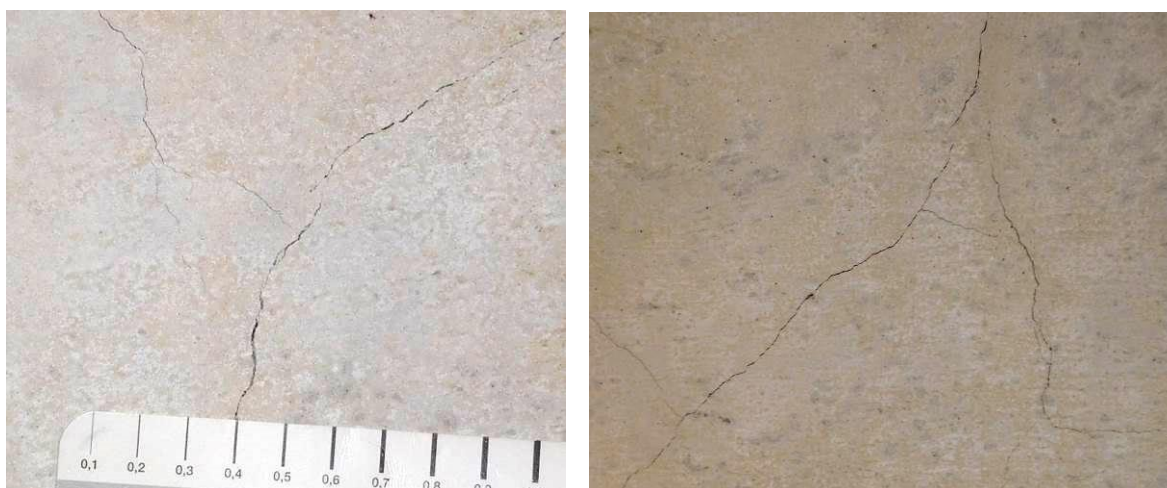
Obr. 20 – Zřetelné trhlinky na spodním líci stropní konstrukce, šířka trhlin cca 0,4 mm (kancelář správce, 3.NP).
