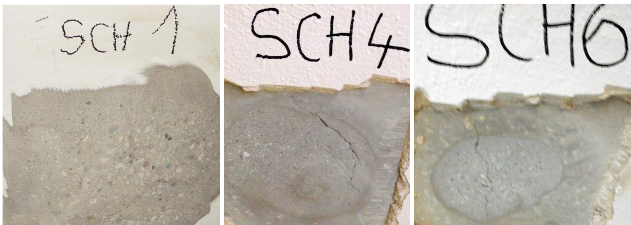
Obrázek 53: Příprava míst pro tvrdoměrnou zkoušku. V některých případech jsou patrné trhlinky stropní deskou.
