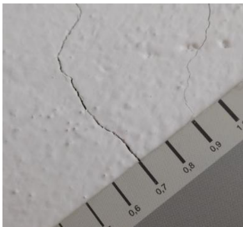
Obrázek 18: Měření šířky trhliny.
