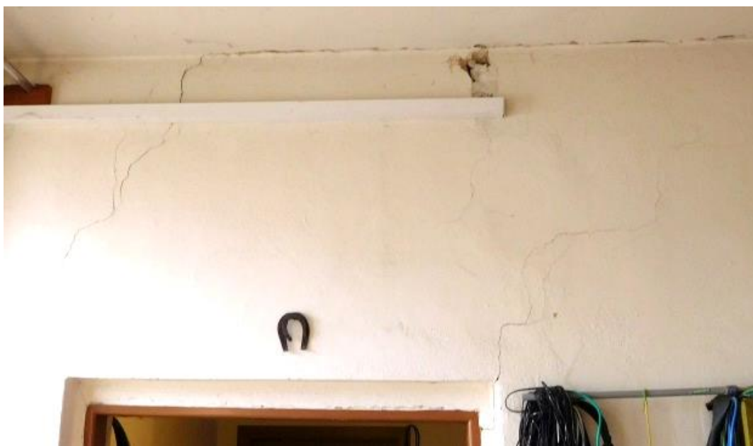
Obrázek 40: Trhliny v příčce, vlevo obvodová nosná stěna (služební místnost, 4.NP).
