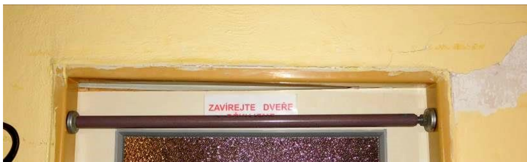
Obr. 16 – Zkosení a deformace dveřního otvoru v příčce (zárubně versus dveře, 4.NP).
