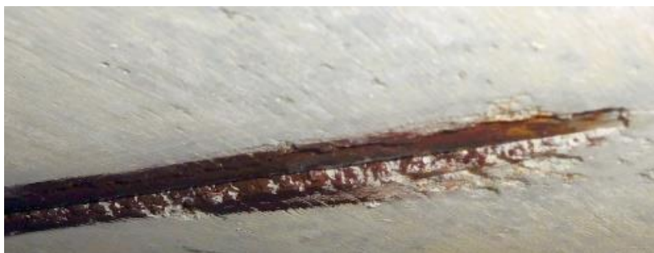
Obrázek 36: Obnažená spodní výztuž, nulové krytí betonem, 3.NP.
