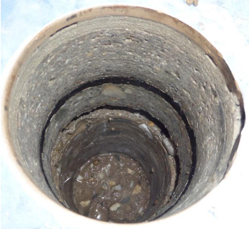
Obrázek 60: Vývrt V2 (strop nad 2.NP, koupelna).
