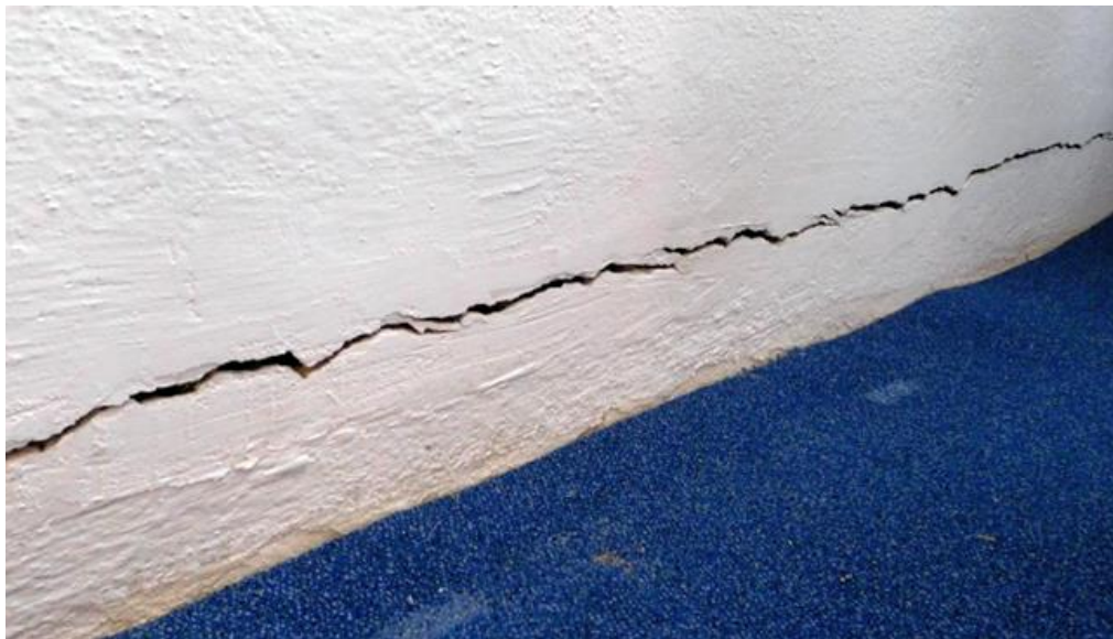
Obrázek 15: Vodorovné odtržení příčky nad podlahou.
