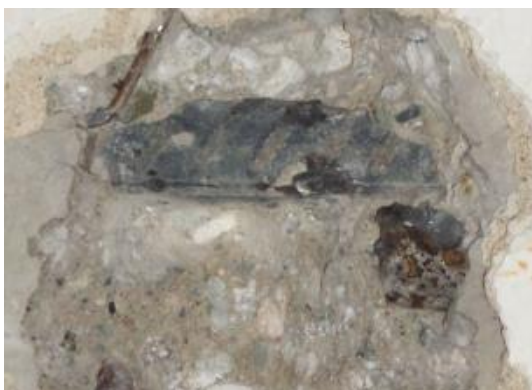
Obrázek 52: Výztuž v sondě D4-5, \phi V22 (spodní povrch stropu nad 4.NP).
