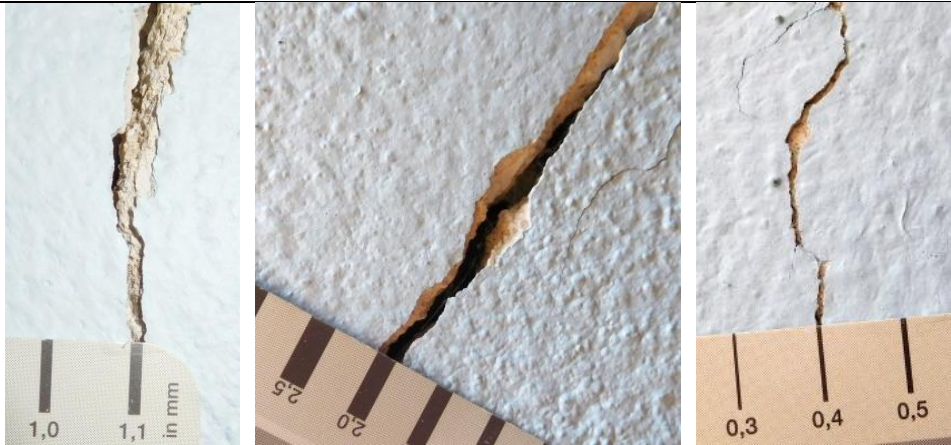
Obrázek 43: Měření šířek trhlin.
