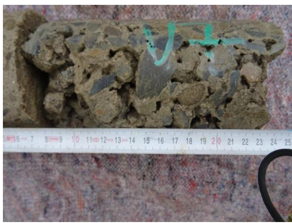
V7. Detailní pohled, pórovitá, kavernová struktura betonu.
