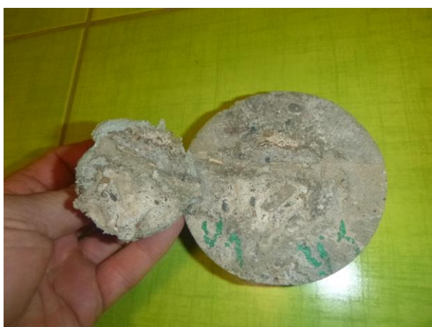
Pohled na kohezní poruchu na vývrty V1 při hodnotě 0,83 MPa.
