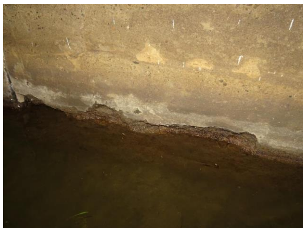
Detailní pohled na vymletou kavernu na dalším místě.
