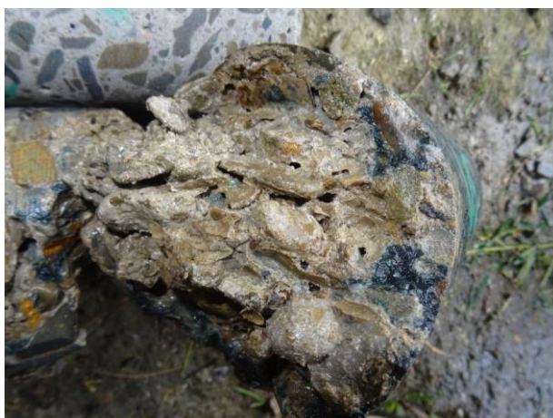
Pohled na rozpad cementového tmele na vývrtu V5.
