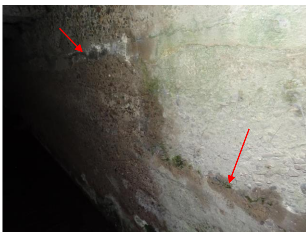
Délka OP2 je 46 m. Výška opěry je cca 1,7 m od nivelety dna. Zatékání přes podélné pracovní spáry.
