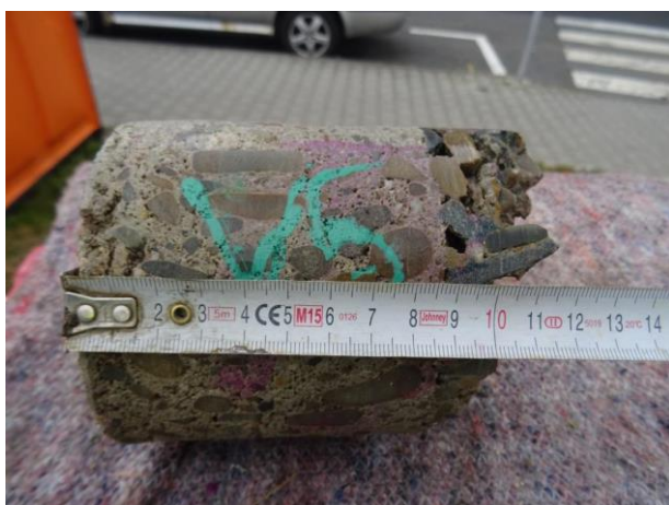
V5. Karbonatace do hloubky 100 a více, proměnná vzhledem k heterogenitě struktury a pórovitosti.
