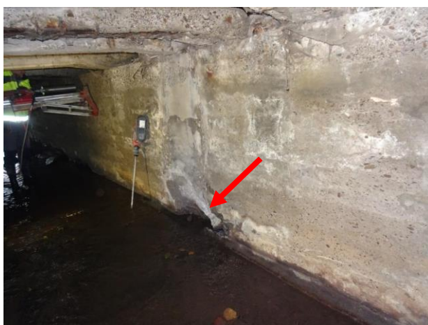
Pohled na degradovaný povrch a vymletou kavernu na straně vtoku.
