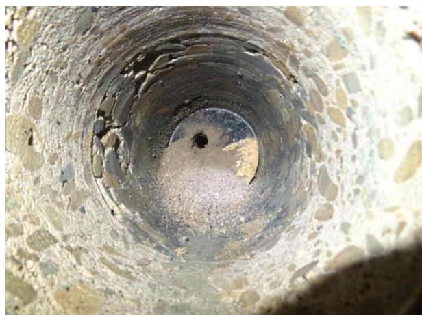
Pohled do vývrtu V5. Viditelné kaverny. Vymytý cementový tmel při jádrovém vrtání.
