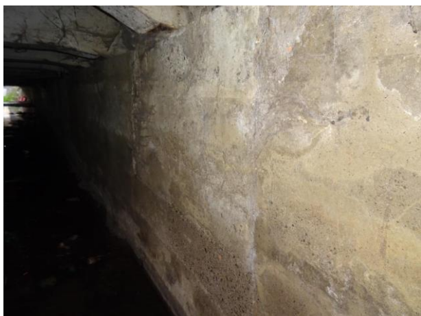
Pohled na degradovaný povrch, vymletou kavernu a viditelné svislé spáry s výluhy.
