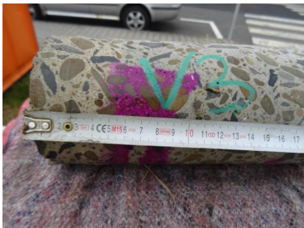
V3. Karbonatace do hloubky 50 mm.
