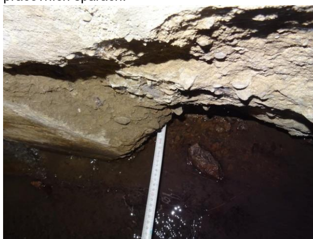
Detailní pohled na vymletou kavernu, rozpad cementového tmele, beton díky opěry z netříděného říčního kameniva se zrny až 60 mm.
