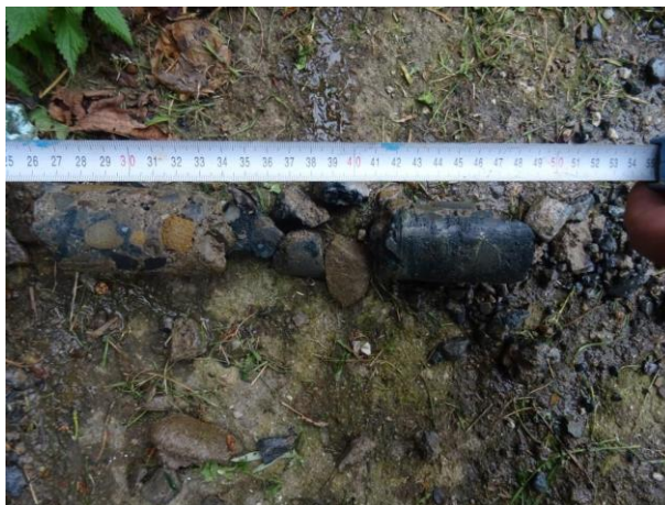
Pohled na jádro z hloubky 60 – 87 cm. Beton vývrtnu se rozpadl.
