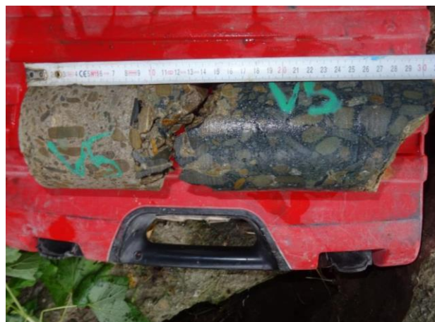
Pohled na vývrt V5 do dřívku OP2. Viditelná přibetonávka. Velká heterogenita betonu.
