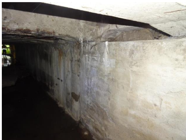
Na opěru OP1 dochází k zatékání z oblasti nosné konstrukce, ale také přes opěry ve vodorovných pracovních spárách.
