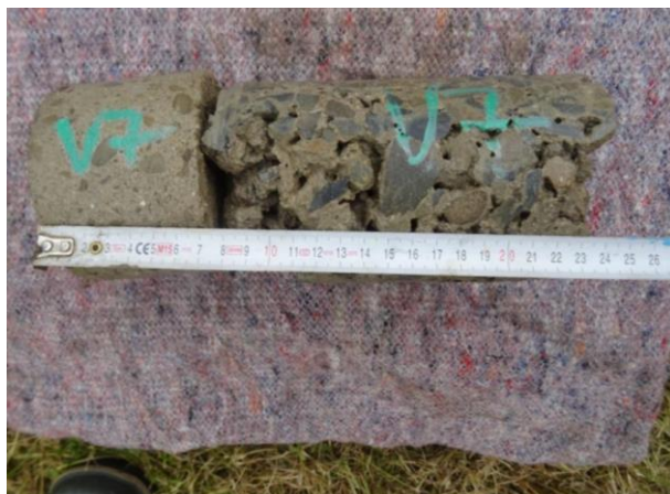
Pohled na vývrt V7 do dříku OP1. Viditelná přibetonávka. Velká heterogenita betonu.
