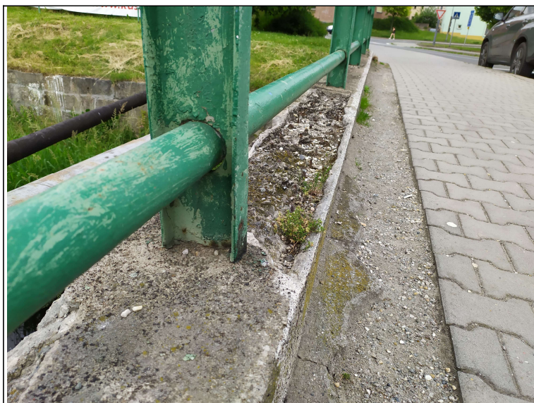
Kotvení zábradlí - rozpadená římsa
