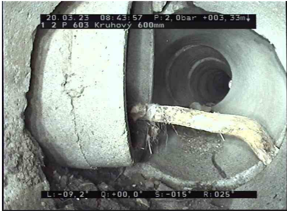
1-2_0f3391d5-f3f0-4146-848f-bf5dac8d52ae_20230320_084433_881.jpg, 00:01:37, 3.33m Vyčnívající (přesazená) kanalizační přípojka od 9 hodin
