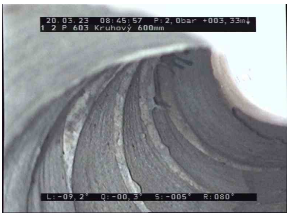
1-2_9e4a5214-31d1-44d0-a7b3-0ab9e9063ff5_20230320_084633_438.jpg, 00:01:54, 3.33m Přerušení inspekce, překážka / kořen a kamení, kamera dál nejede
