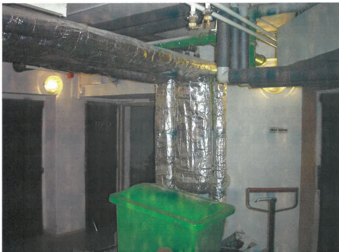
Rozvody energií v 1.PP budovy.
