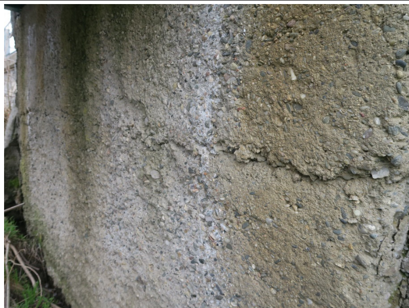
Detail OP1 s horizontální trhlinou.
