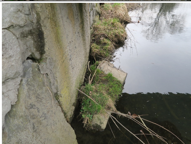
Nesouvislé zajištění paty dříku u OP1.
