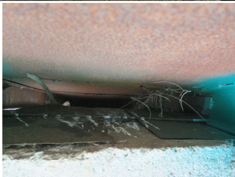
Ocelové plechy na OP1 fungují jako ložiska.
