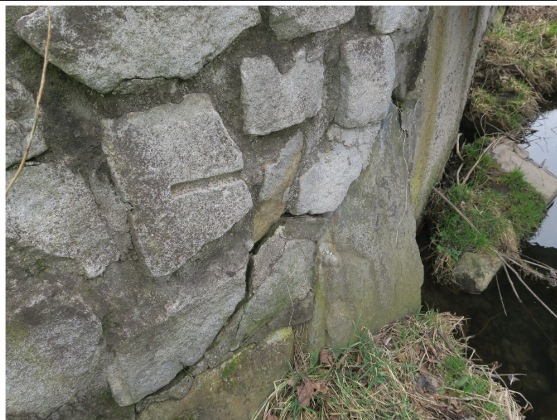
Trhlina v dlažbě křídla u OP1.
