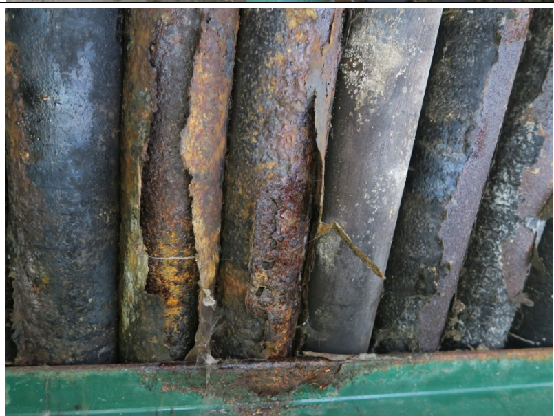
Některé trubky mostovky již s rozpadem.
