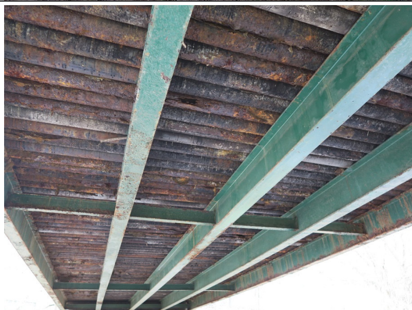
Podhled NK. Zkorodované výmětové trubky.
