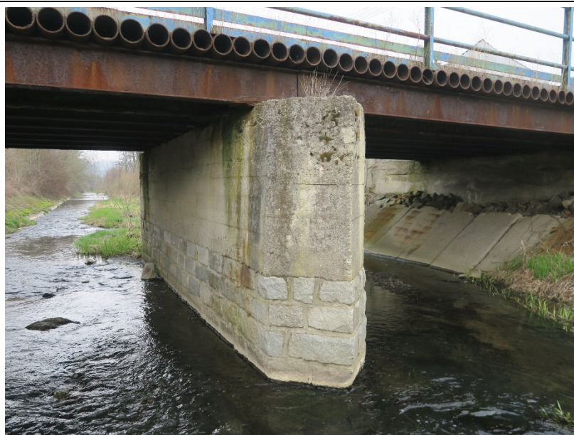
Pohled na středový pilíř zprava, ve směru toku Zrzávky. Kmenná část OK. Betonové úložné prahy v horní části s rozpadem betonu.
