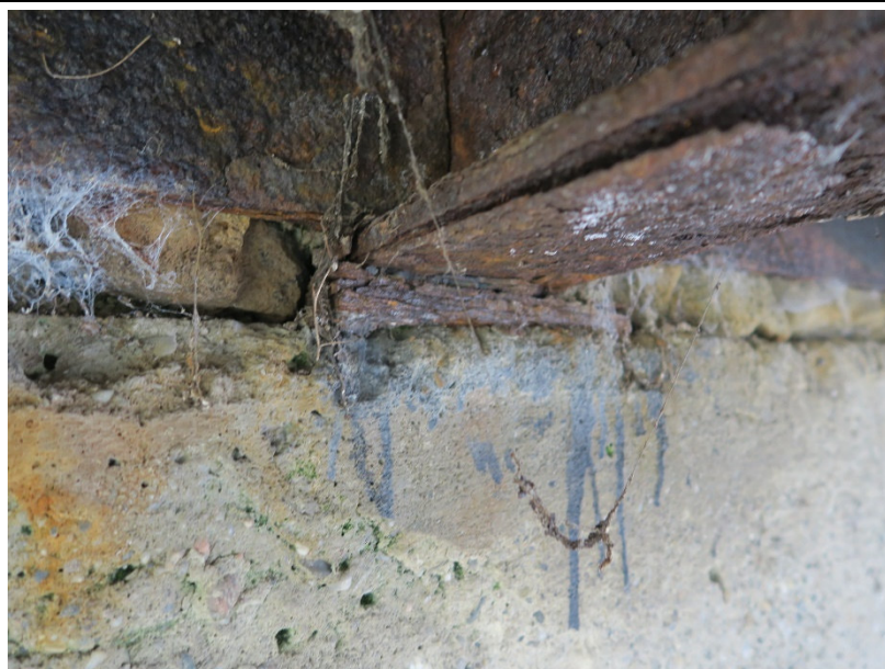
Typické ložisko na mostě. Rozpad oceli i betonu.
