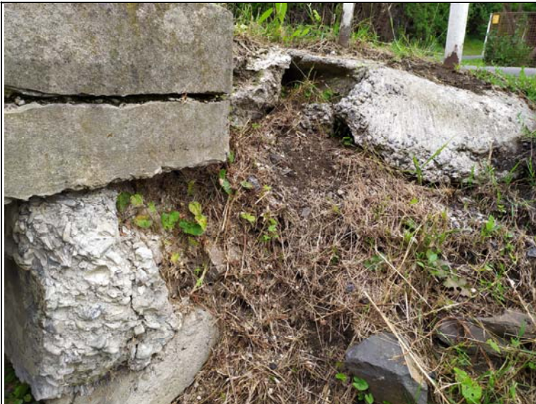
Eroze za opěrou 1 vlevo
