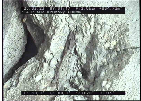
3-4_fc2f585a-83a6-45a3-afb4-86b68df64baf_20230320_090153_488.jpg, 00:02:30, 4.73m Obecná poznámka / upadnuté dno, rozjetý spoj
