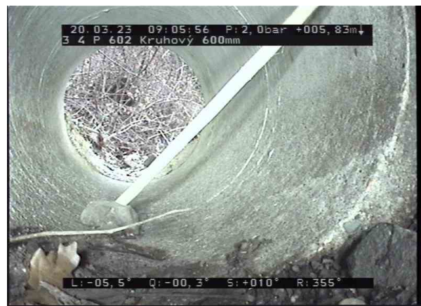
3-4_c6e1f57c-43de-42e8-8d0a-db49c0a1d169_20230320_090632_467.jpg, 00:04:27, 5.83m Přerušení inspekce, překážka / větve a kamení, kamera dál nejede
