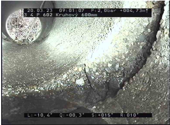
3-4_2a56aa09-f153-46bf-9931-2288661afc44_20230320_090143_938.jpg, 00:02:30, 4.73m Obecná poznámka / upadnuté dno, rozjetý spoj
