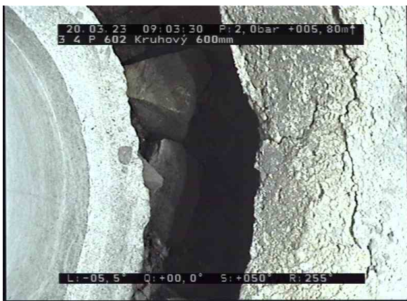
3-4_5e82d531-e42c-4fc6-bf38-f03de20899fc_20230320_090406_937.jpg, 00:03:59, 5.80m Obecná poznámka / chybí část potrubí, hrozí samovolné uvolňování zeminy a zanášení potrubí
