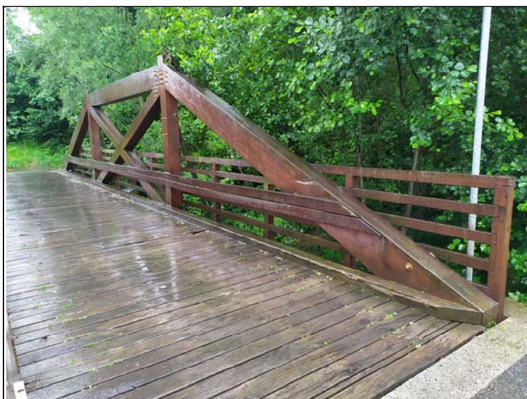
Levé věšadlo se zádržným systémem - s pohledem o opěře 1
