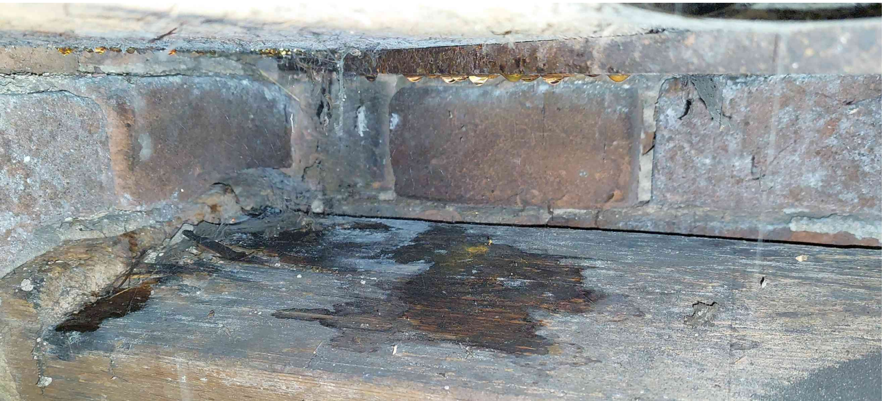
Obr. 7: sonda S5, kondenzace na ocelovém prvku, mokrý trám
