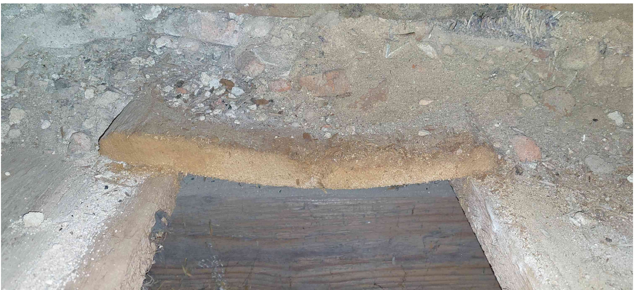
Obr. 4: sonda S2, degradace horní části desky záklopu
