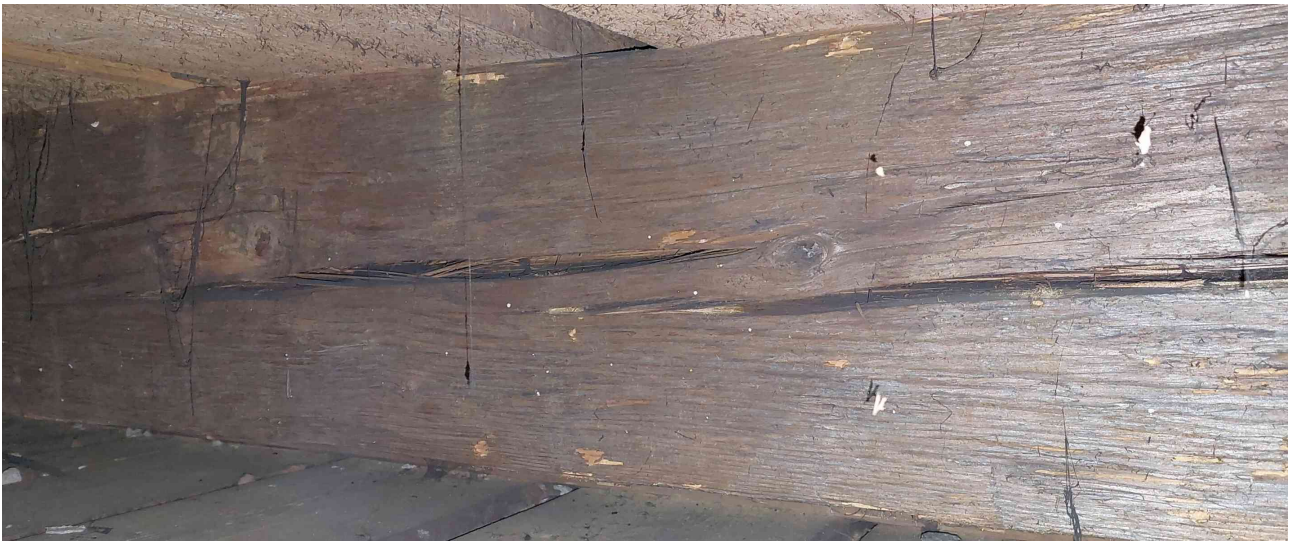
Obr. 6: sonda S6, stropní trám nese stopy po degradaci tesaříkem
