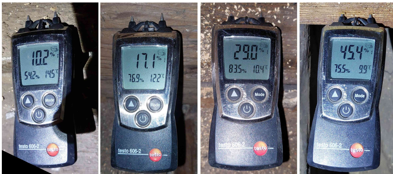
Obr. 2: vlhkosti stropních konstrukcí
