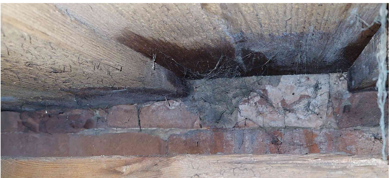
Obr. 5: sonda S3, mokré konce desek záklopu osazených do zdiva
